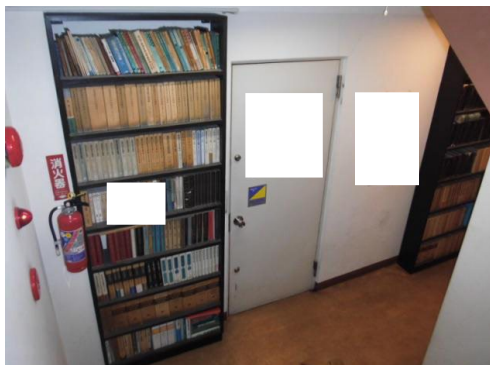
5階通路部分の木製本棚及び書類等の状況
